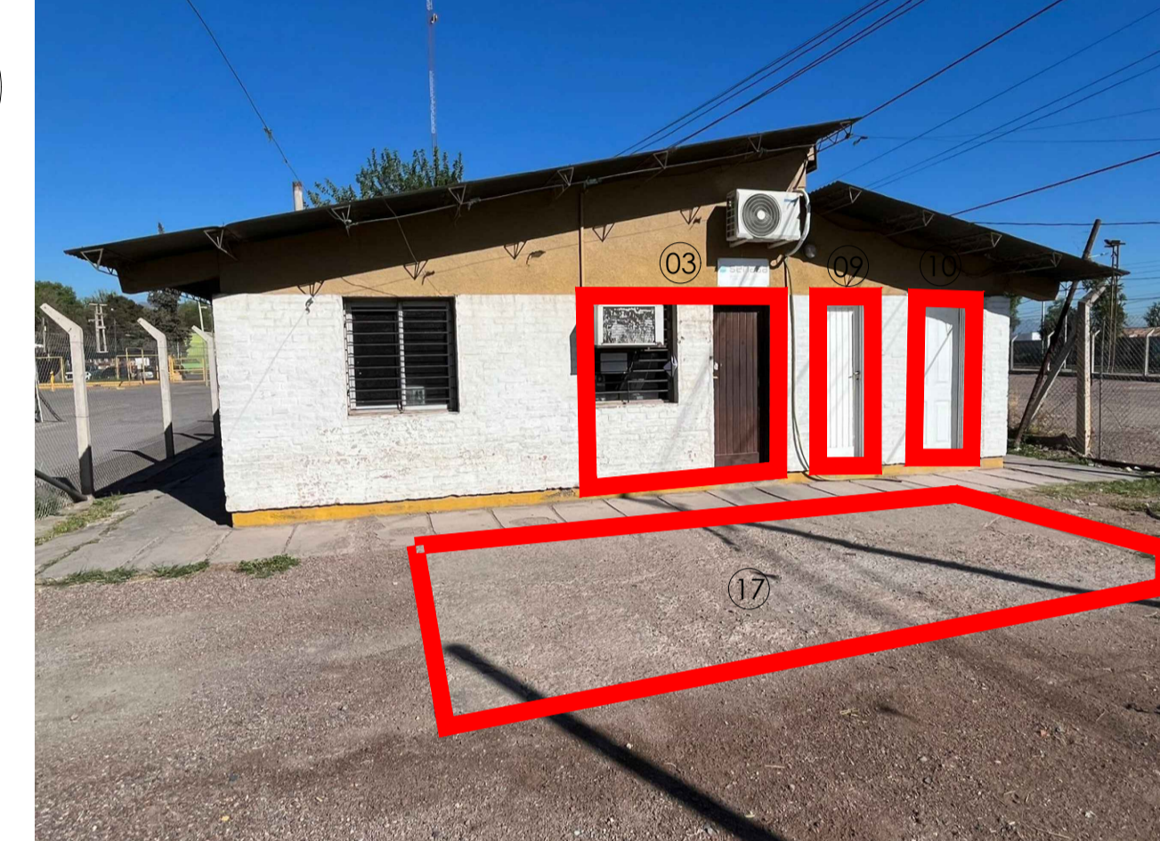
NOTA: PUERTA 09 Y 10 A RETIRAR SERÁN REUTILIZADAS EN ACCESOS PARA BAÑOS (SENASA Y PUERTO SECO)
