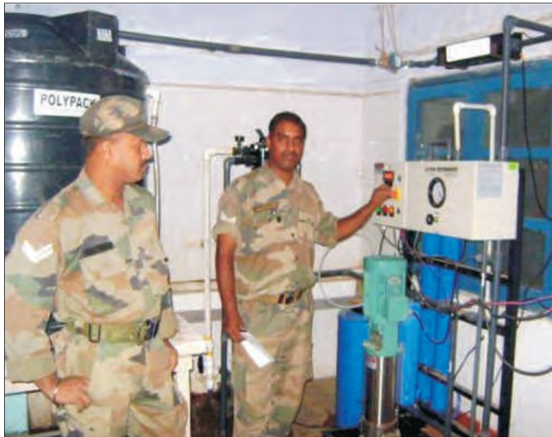
Foto N°3: INDRO (procedimiento por osmosis inversa)
